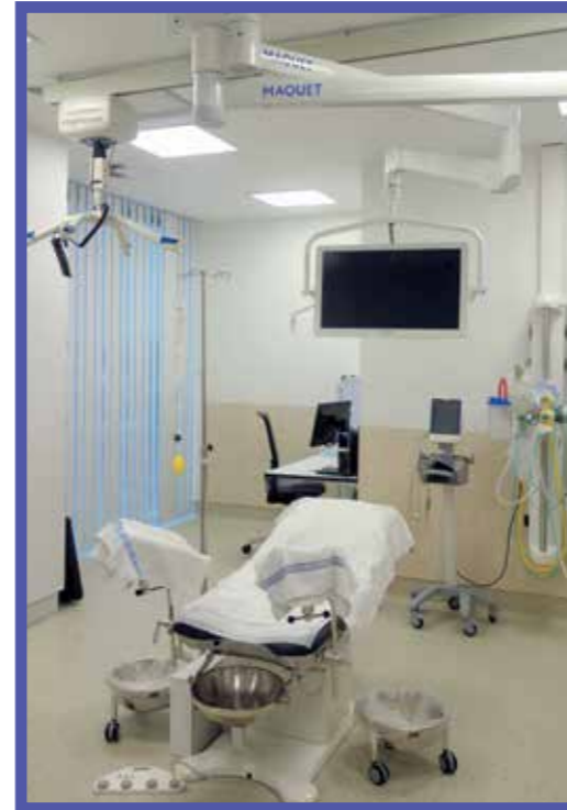
Plafondlift ziekenhuis Brussel
