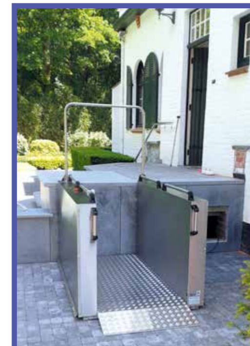
Ascenseur pour fauteuil roulant chez un particulier à Varsenare
